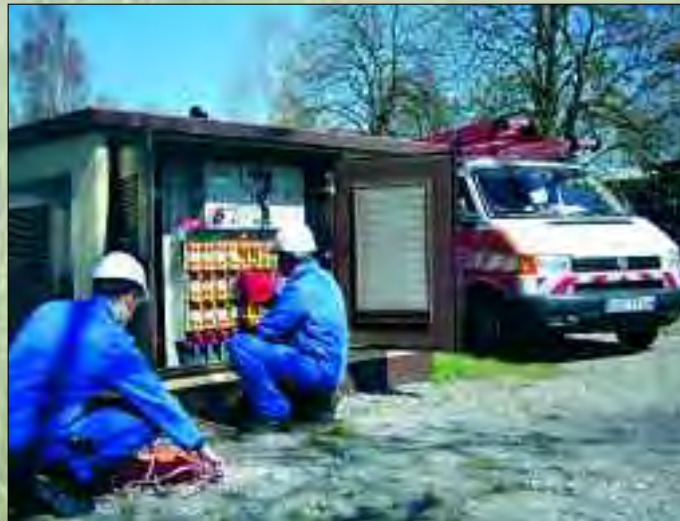
Bei einer Störung oder Schadensfall sind die Monteure in kurzer Zeit vor Ort, um eine zügige Wiederversorgung zu gewährleisten
