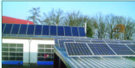
Beispiel einer Solar-Anlage für Heizungsunterstützung und Stromerzeugung
